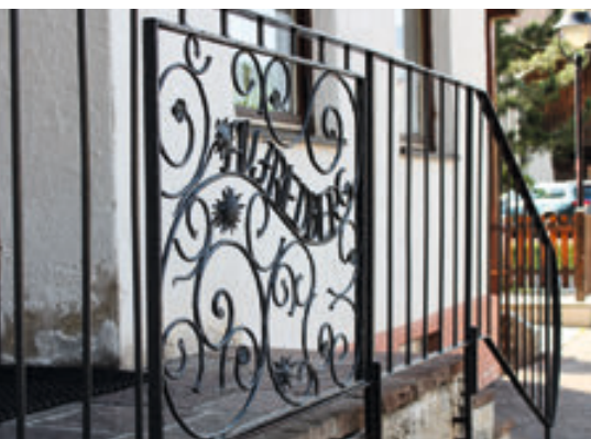
Während wir auf Wandschaft waren, setzte Hüttenwart Martin Miller das vom Berghaus Rinnen mitgebrachte schmiedeeiserne Schmuckstück in das vorhandene Geländer am Hauseingang ein.
